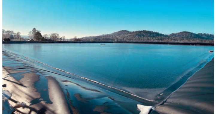
Gefülltes Speicherbecken mit 26.600 m 3 Wasser.
