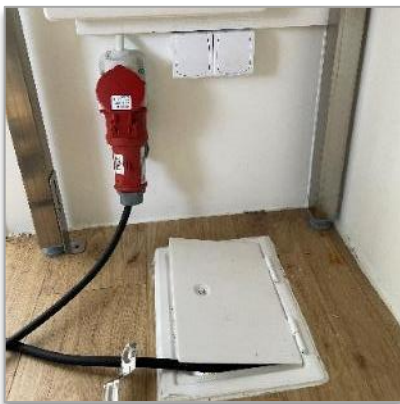
Bild 1: 16 A Anschluss im Spülmobil
