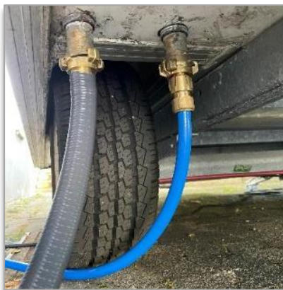
Bild 3: Trinkwasser- und Abwasseranschluss am Spülmobil
