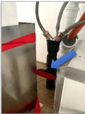
Bild 26: Öffnen des Wasser-Haupt- ahnes unter der Spüle
