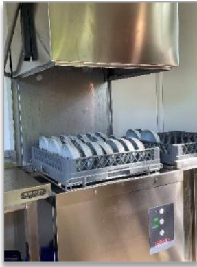
Bild 29: Geöffnete Haube der Spülmaschine mit Spülgut
