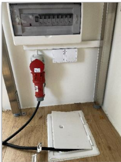
Bild 1: 16 A Anschluss im Spülmobil
