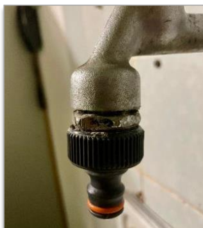
Bild 4: Trinkwasseranschluss außerhalb des Spülmobils
