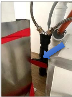
Bild 26: Öffnen des Wasser-Haupt- hahnes unter der Spüle
