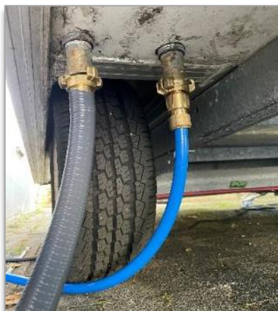
Bild 3: Trinkwasser- und Abwasseranschluss am Spülmobil
