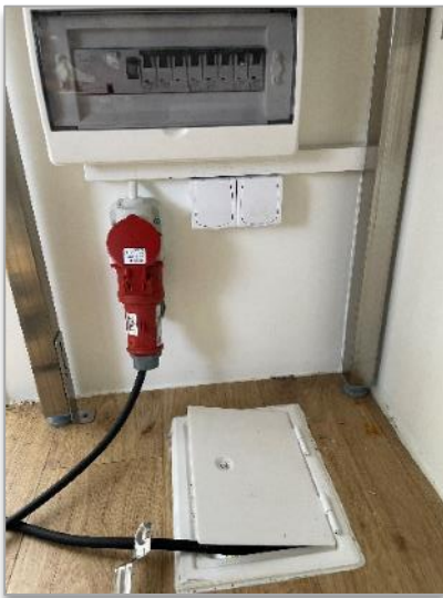
Bild 1: 16 A Anschluss im Spülmobil
