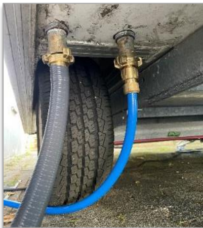
Bild 3: Trinkwasser- und Abwasseranschluss am Spülmobil
