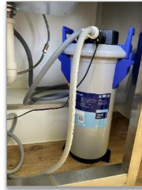
Bild 31: Der Wasserfilter unter der Spüle ist dauerhaft angeschlossen und betriebsbereit
