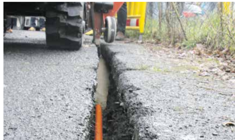
Beim Verlegen der Glasfaserkabel beschleunigt Trenching das Arbeiten: Dabei wird unmittelbar hintereinander ein Mikro-Graben gefräst, ein Breitbandkabel verlegt und der Graben verfüllt. (Foto: Landkreis Marburg-Biedenkopf)
