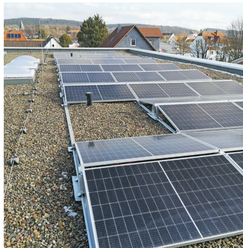
Auf dem Neubau der Grundschule Wetter befindet sich eine der Photovoltaik-Anlagen. (Foto: Landkreis Marburg-Biedenkopf)
